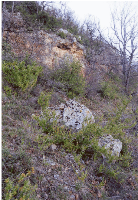
affleurement rocheux – brèche de pente et blocs déstabilisés
