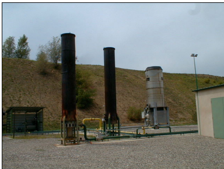
PHOTOGRAPHIE 8 : TROIS TORCHERES (UNE EN FONCTIONNEMENT ET DEUX PRESENTES EN CAS DE PROBLEME)
