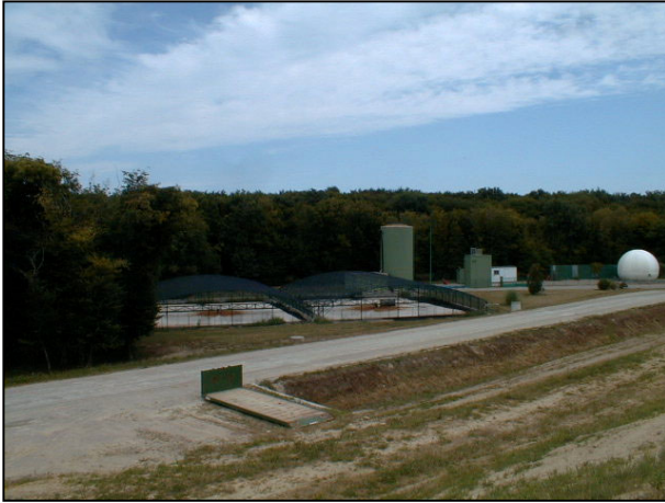
Photographie 5 : bassins d'aération pour les lixiviats
