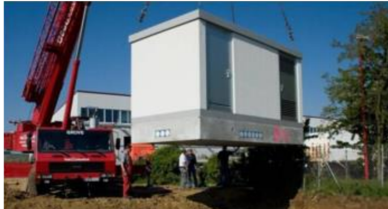
Figure 94 : Livraison d'un local technique
