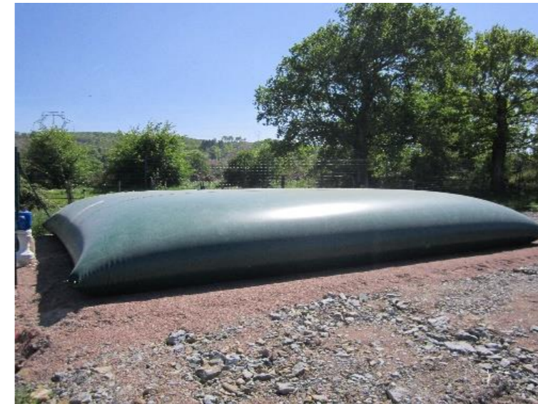
Figure 88 : Photo d'une bâche incendie
