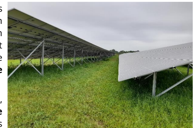
Reprise végétale sous les panneaux photovoltaïques
