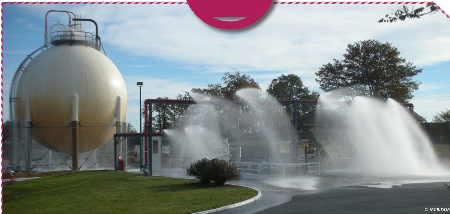
Exercice de crise lors d'un scénario de fuite de gaz sur les installations de l'usine SOBEGAL
